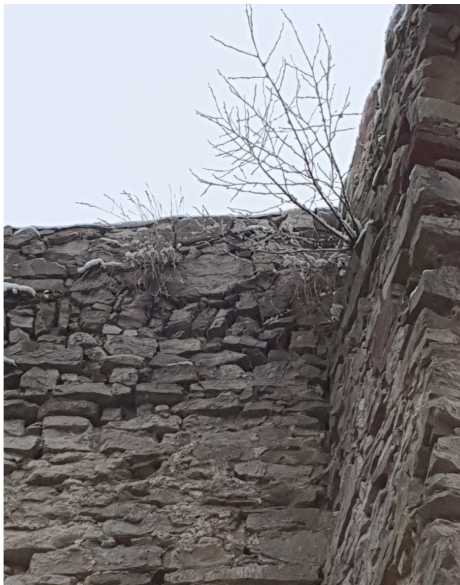
Fot. Nr 4: Ruiny Zamku „Krzyżtopór”, Ujazd –samosiejki bylin, drzew i krzewów wrastające w spoiny wątków murowych. Autor zdjęcia: Katarzyna. Dziwińska-Lesińska, grudzień 2021.
